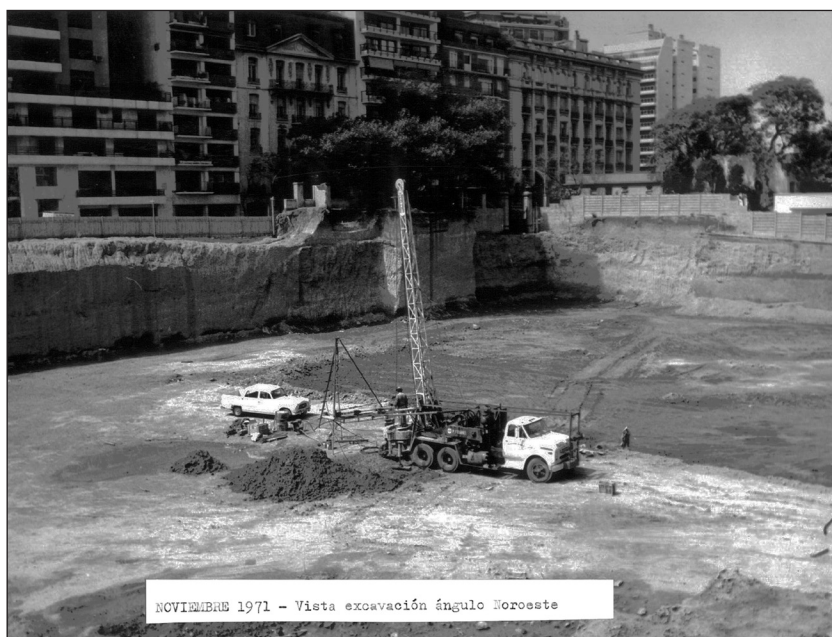
Comienzo de la construcción de la Biblioteca Nacional en el predio que ocupaba la Mansión Unzué, 1971.
